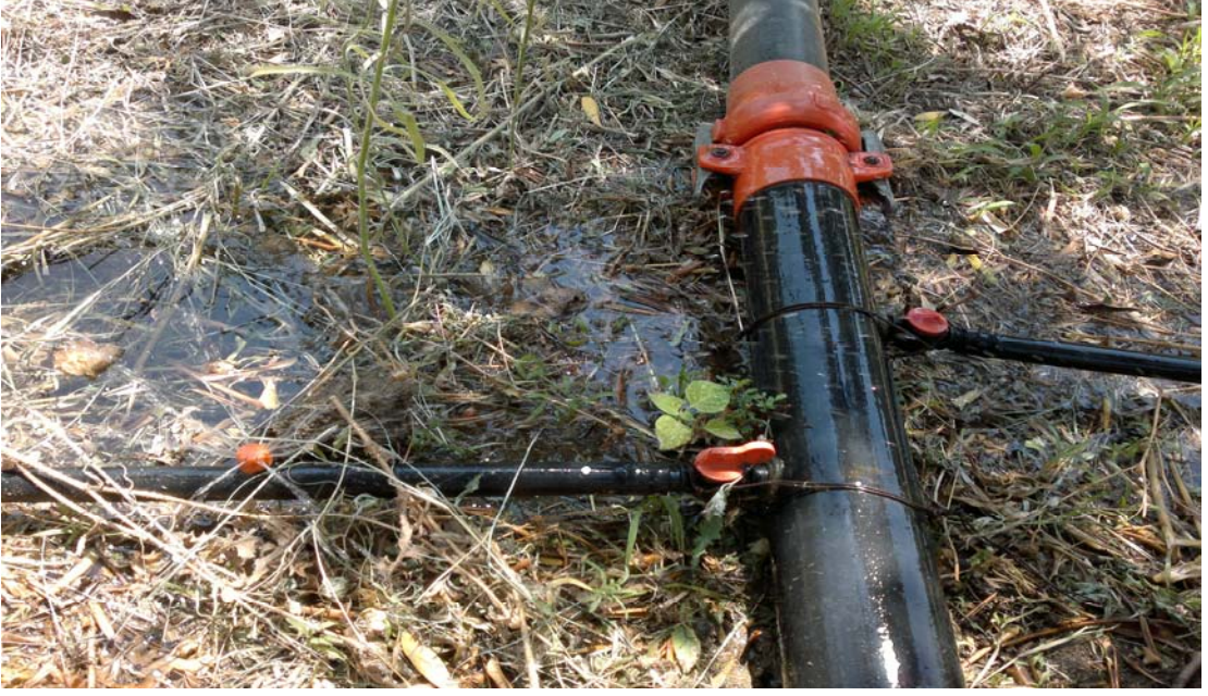
Şekil 4.2. Lateral borularda bağlantı noktasında oluşan su kayıplarından bir görüntü
