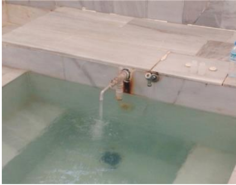
Şekil 3.20. TK-8 sondaj suyunun verildiği termal havuz (2014)
