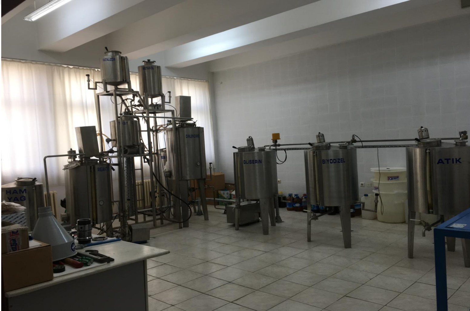
Şekil 3.4. PLC destekli pilot üretim tesisi
