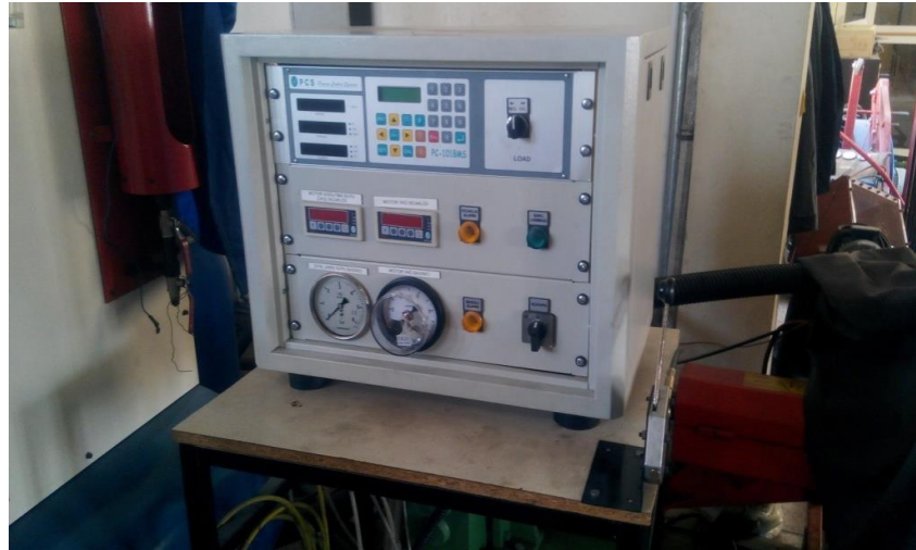
Şekil 4.6: Motor Dinamometresi Kontrol Paneli
