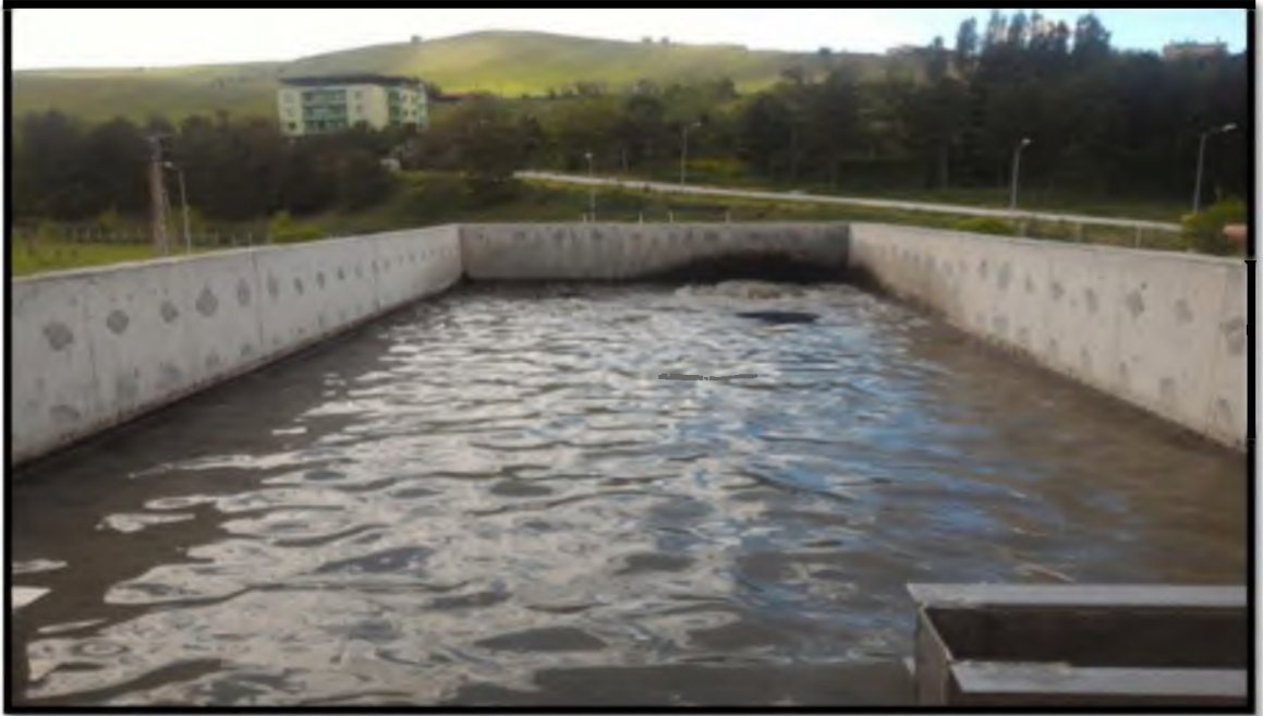
Şekil 4.1. Tesis Terfi İstasyonu ve Terfi Havuzu.
