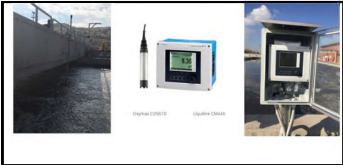
Şekil 4.13. Kayseri Atıksu Arıtma Tesisi Oksijen Metre ve Enerji Tablosu (Medya, 2017).
