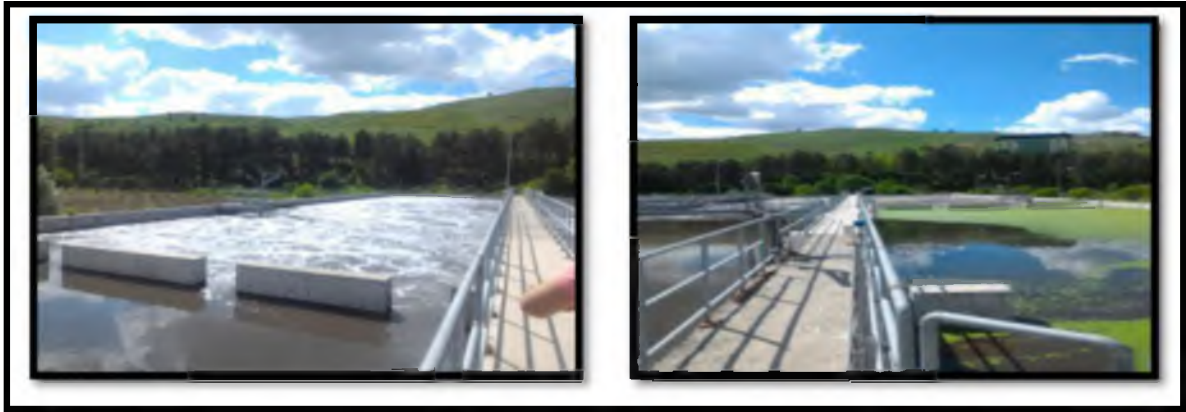
Şekil 4.4. Tesis Havalandırma Havuzları.
