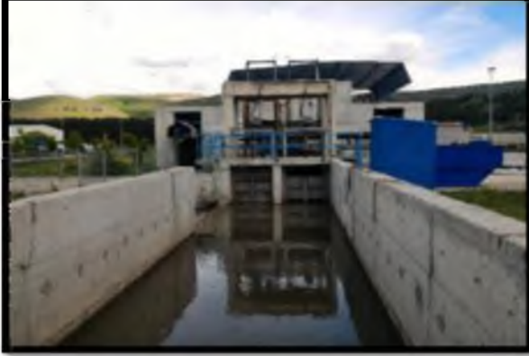
1. Kaba Izgara Yapısı
