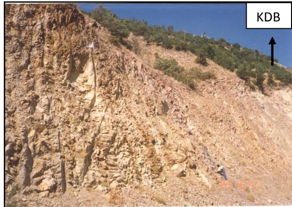
Şekil 6.23 Bazaltlarda çatlakların görünümü
