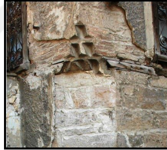
Resim 62. Cepenin Köşesinde Tuğla Süsleme Restorasyon Öncesi
