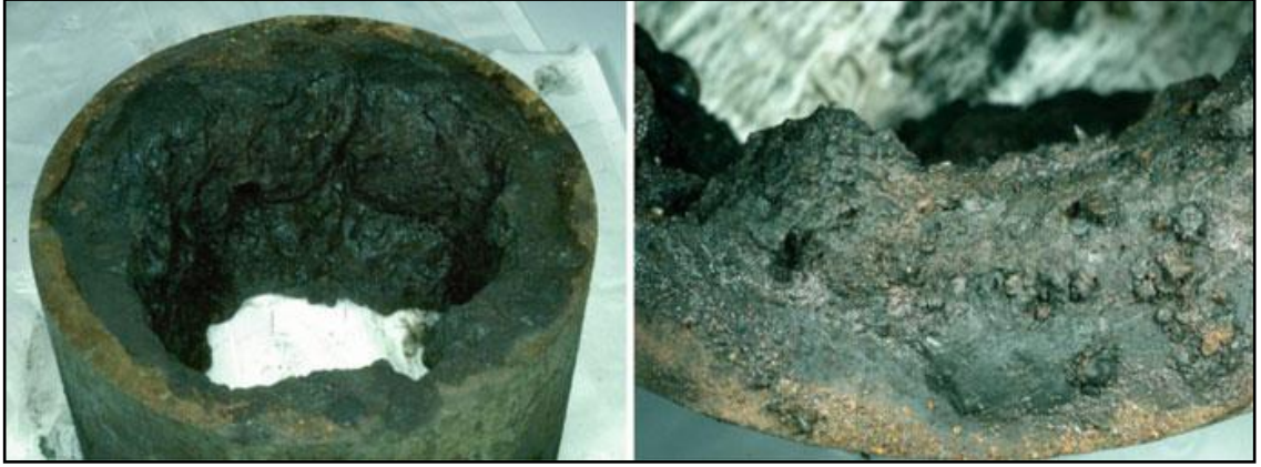
Şekil 2.1 Almanyanın Berlin şehrinde 80 yıldan daha fazladır kullanılmakta olan demir dökümden yapılmış içme suyu borularında oluşan biyofilmler (Szewzyk vd. 2011)
