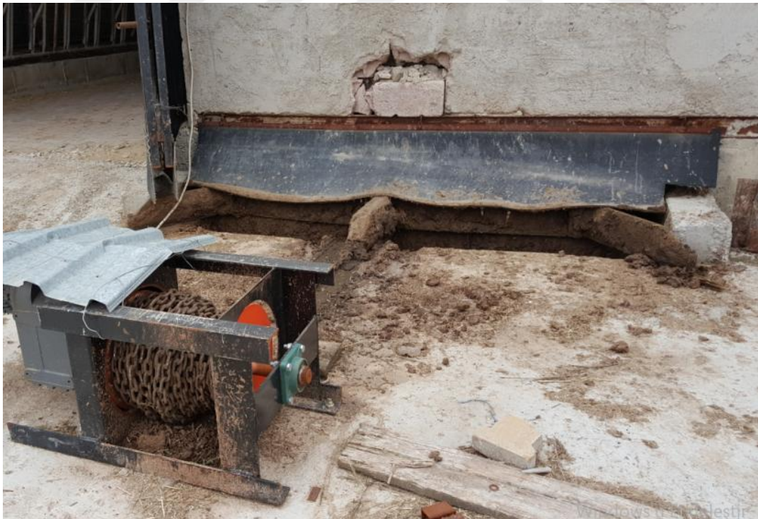
Şekil 4. 10. Araştırmada incelenen 6 nolu serbest sistem barınaklardaki süt sığırı işletmesinde gübre çukuru girişi
