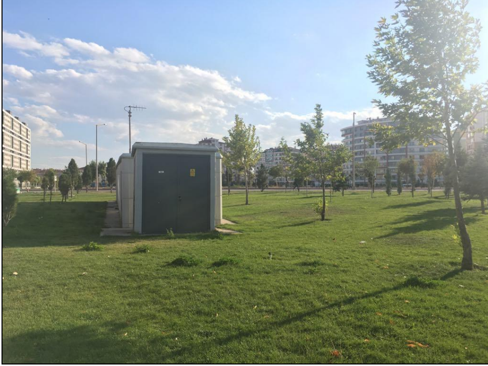
Şekil 4.28. Elektrik trafosu (Orijinal, 2019)
