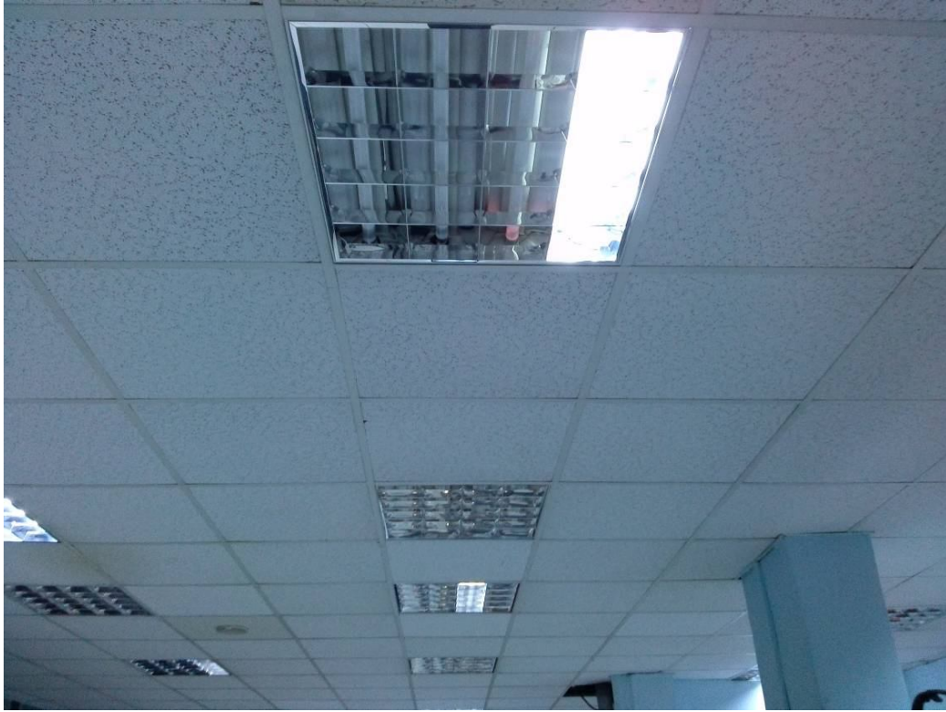
Şekil 1.7. Laboratuvarlardaki yetersiz aydınlatma kaynakları.
