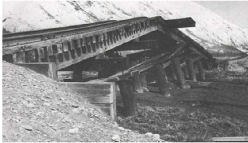
Őekil 2.20. Yanal yayılma nedeniyle kazık ayaęın dikey bklmesi [42]
