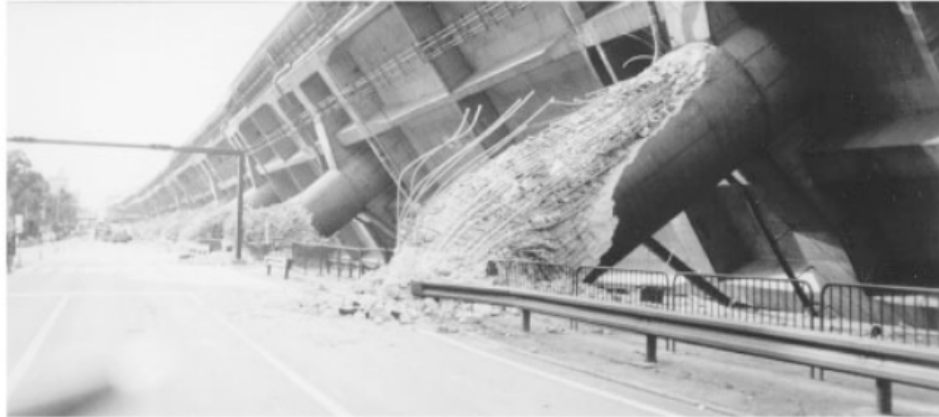
Şekil 2.3. 1995 Kobe depreminin Higashi-Nada viyadüğüne etkisi [27]
