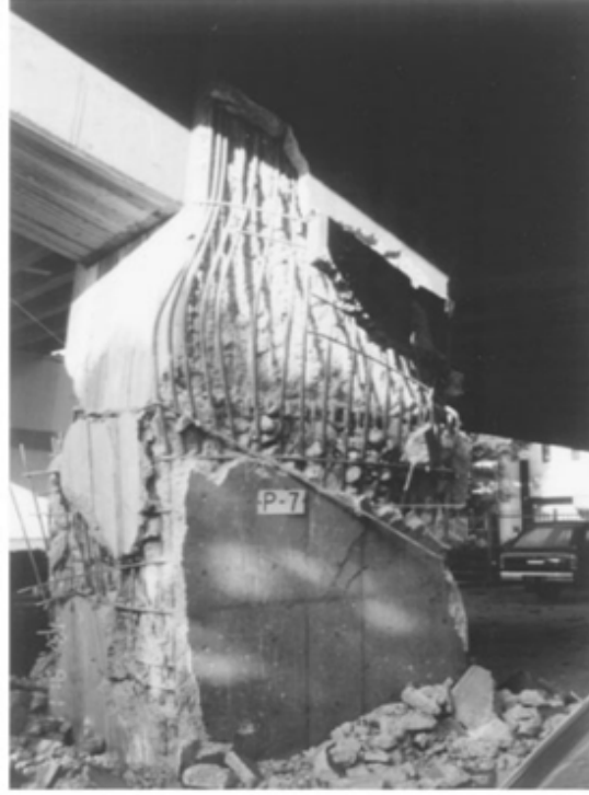
Şekil 2.9. 1995 Kobe depreminde orta yükseklikteki bir kolonda boyuna donatıların akmasından kaynaklı Yenilme
