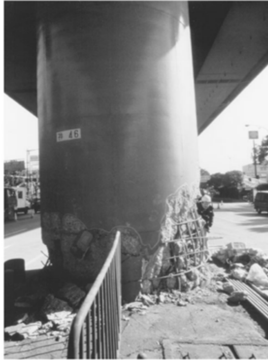
Şekil 2.8. 1995 Kobe depreminde Hanshin otoyolu köprü ayağı hasarı
