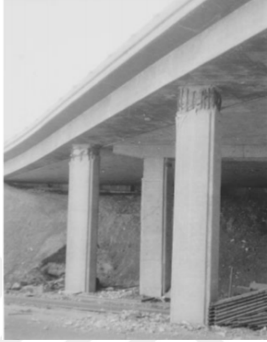
Şekil 2.7. 1971 San Fernando depreminde San Fernando yolu kolon başlıkları hasarı
