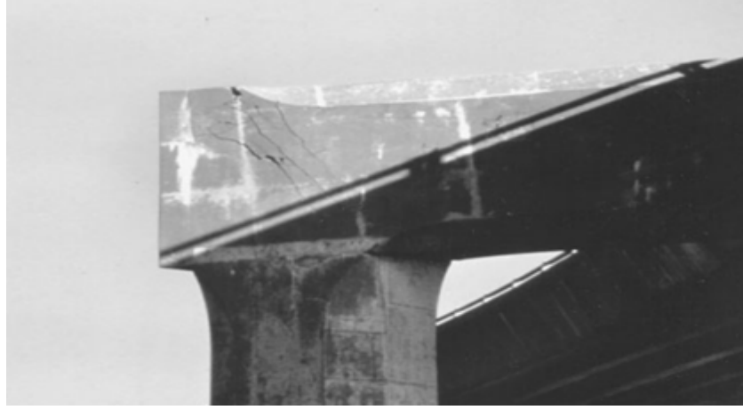
Şekil 2.12. 1989 Loma Prieta depreminde kiriş hasarı
