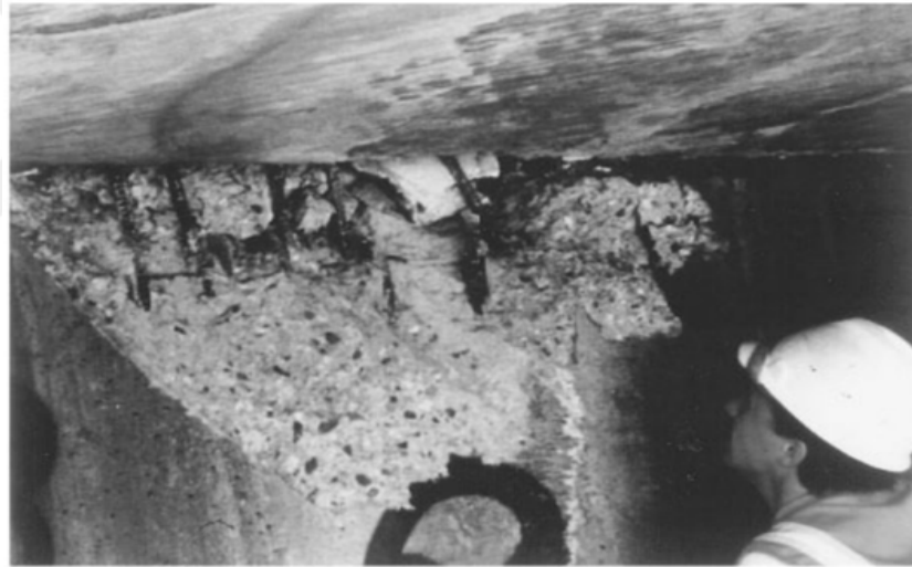
Őekil 2.15. 1994 Northridge depreminde bir köprü ayaęının iç deprem takozu hasarı [34]
