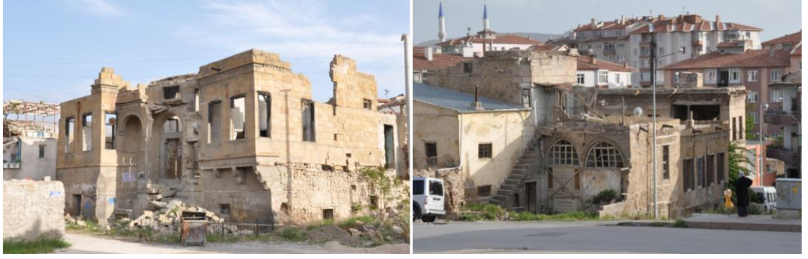
Şekil 4.64 Yıkıntı ve harabe durumunda olan yapılar (Orijinal 2017)
