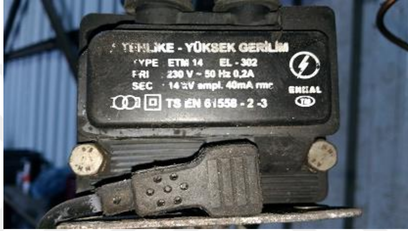
Şekil 3.12. Sistemde kullanılan ateşleme trafosu.
