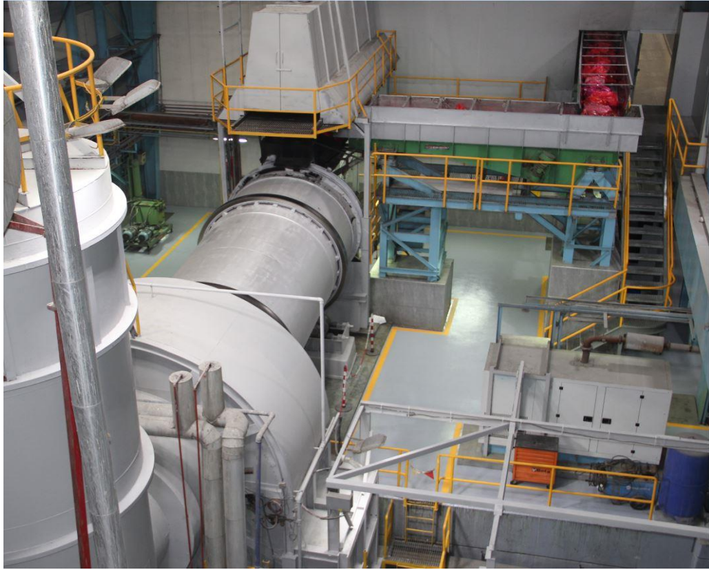
Şekil 3.4. İSTAC A.Ş. Tıbbi Atık Yakma Tesisi
