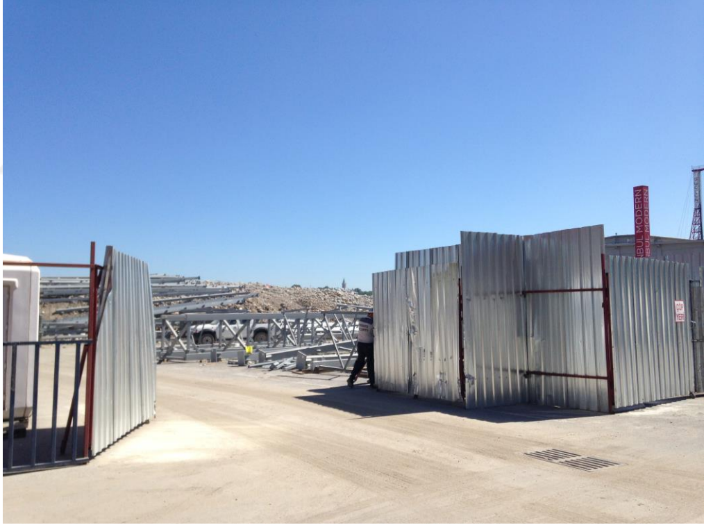
Şekil 4.61 Yıkılan antrepo alanı (Orijinal, 2016)
