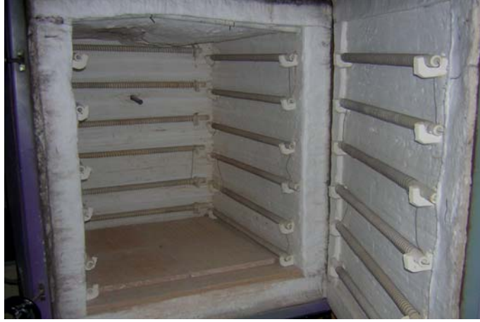
Fotoğraf No:188. Elektrikli fırının iç görünüşü.
