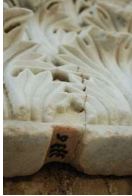
Resim 2: Mimari Parça Akanthus Yaprađı çatlaklar detay
