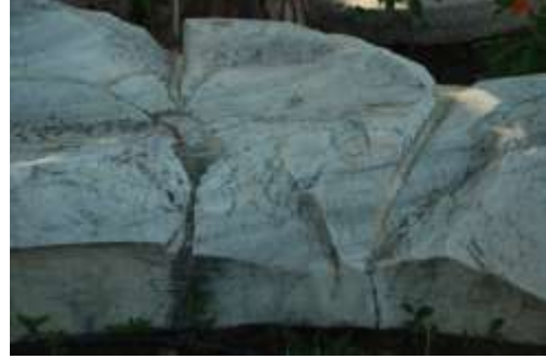
Resim 2: Koltuk kırık ve çatlaklar detay
