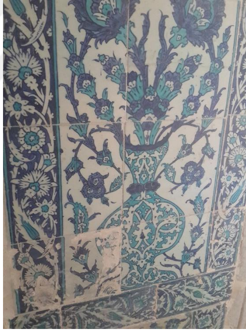
Resim 93: Tamamlama Yapılan Alandaki Bozulma
