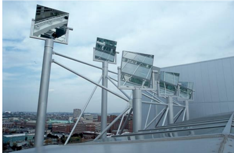
Şekil 4.16 Çatıda ve atrium boyunca kullanılan yansıtıcı paneller (heliostat)
