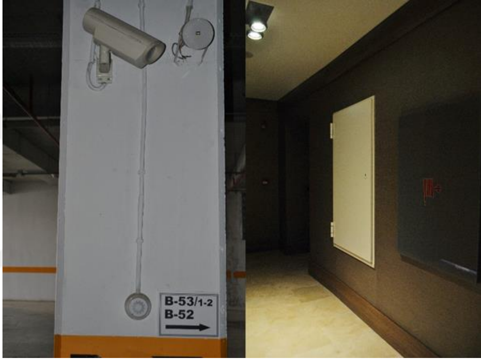
Şekil 4.5 Otopark ve iç mekanda yangın (duman ve ısı dedektörleri) ve güvenlik saha elemanları (Foto: Kişisel arşiv, 2017)
