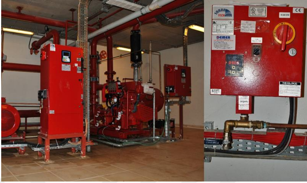
Şekil 4.6 Yangın su deposu, pompa, sprinkler boru dağılım grubu (Foto: Kişisel arşiv, 2017)
