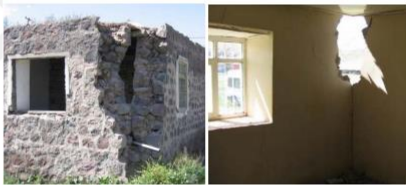
Resim 10: Bloklaşma sonucu yıkılan duvar parçaları (Çırak, 2011)
