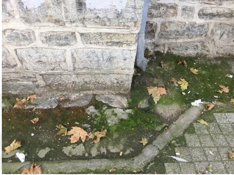
Resim 89: Yapının kenarında oluşan yosunlaşma (Begüm Gökdağ Arşivi, 2018)
