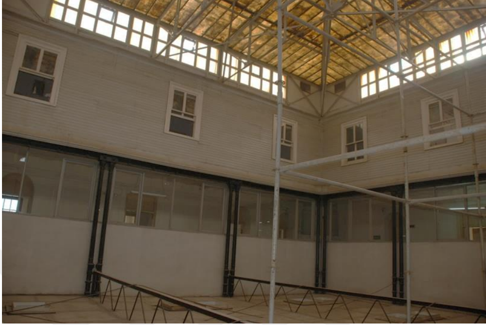
Resim 65: Tavanın renovasyon öncesi durumu (Yapı İşleri, 2010)
