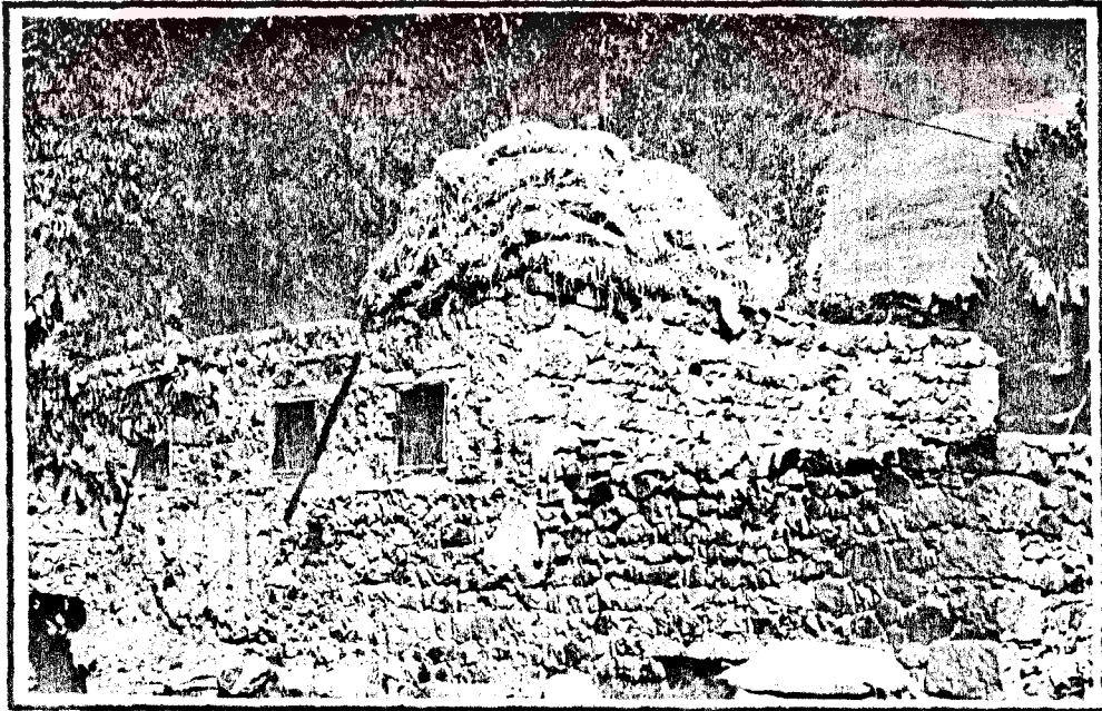
Foto:3. 6- Üzümlü'de işlenmemiş taş kullanılarak yapılmış bir eklenti görülmektedir. Taşların tutturulmasında çamur harcı kullanıldığından, bu tür yapılar deprem bakımından oldukça sağlıksız şartlara sahiptirler.
