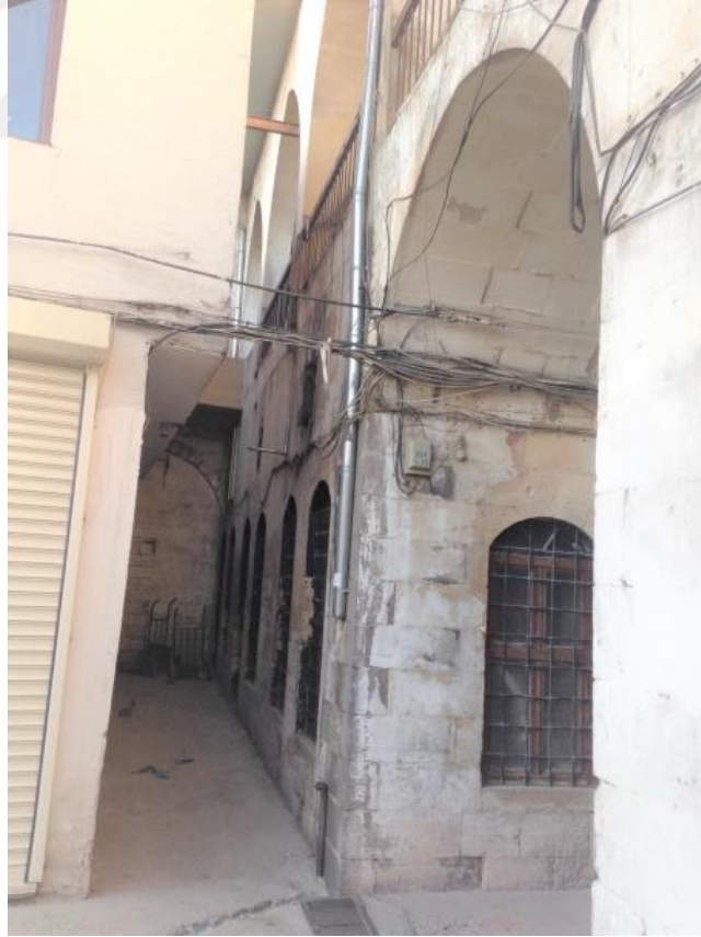
Şekil 4.324 Güven Hanı doğu kanadının zemin katında beton yapının arka kısmında kapatılmış eyvan görünmektedir. (Zincircioğlu, 2018)
