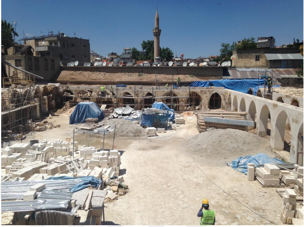
Şekil 4.87 Mecidiye Hanı restorasyon inşaatı çalışması, batı güney ve doğu kanatları ile avlu görünümü (Zincircioğlu, 2018)
