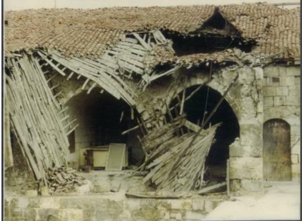
Şekil 4.4 Emirali Hanı doğu kanadında çökmelere ait fotoğraflar 1992 (Koruma kurulu arşivi, pdf no 1023)
