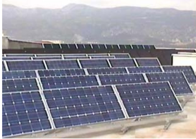
Şekil 1.1 Güneş enerjisini elektrik enerjisine çeviren 10kWp'lik fotovoltaik güç sistemi 1 .
