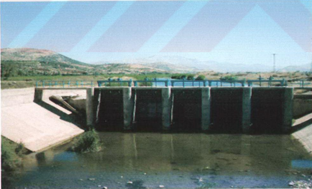
Foto 24: Gölbaşı gölleri kanalla birbirine bağlanarak regülâtörler yardımı ile biriken su Gaziantep'in içme suyu ihtiyacını karşılamak üzere kanaldan Aksu çayına aktarılır.
