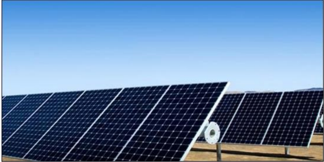
Şekil 1.7 Solar Star Güneş Enerji Santrali [16].
