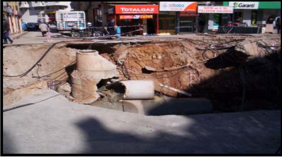
Foto 20: Alt Yapı Çalışmalarından Kaynaklanan Görüntü Kirliliği (Ulusoy Bulvarı).
