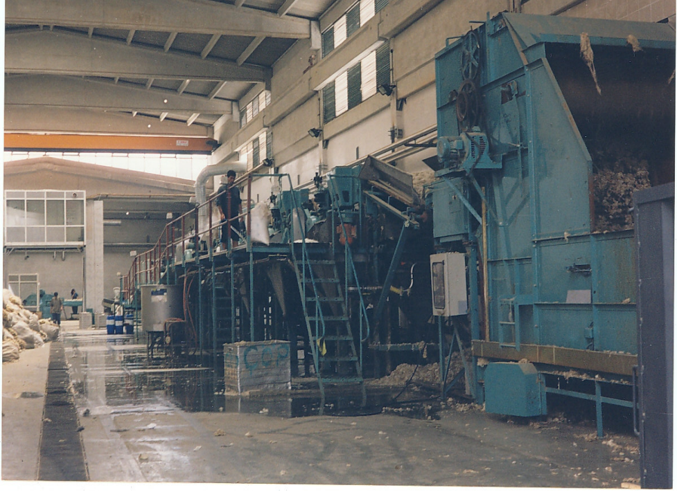
Foto 5: Yün Yıkama Tesisinden Genel Bir Görünüm
