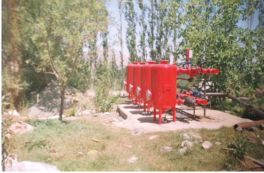
Foto:14. Doğanşehir Ovasının güneyinde yer alan 300 dönümlük arazi sulayan su filtre tesisinden bir görüntü
