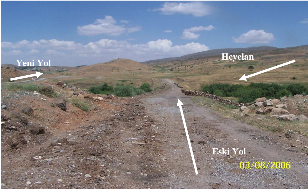
Foto28: Heyelanın yaptığı tahribat nedeniyle Erzurum-Bingöl karayolunun yeri (Kalecik'te) değiştirilmiştir
