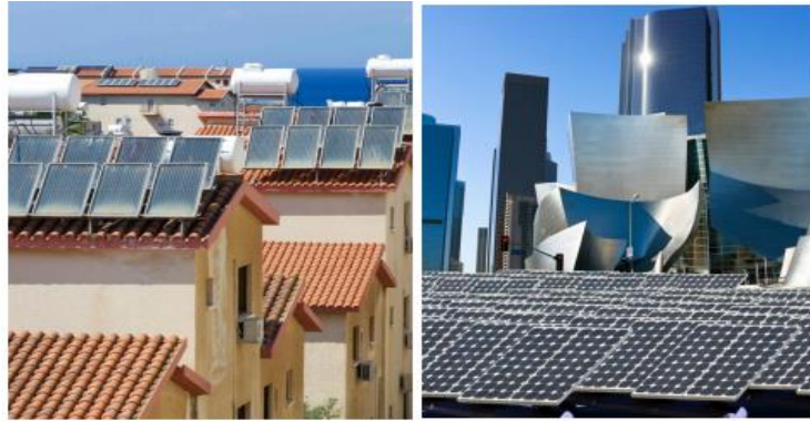
Şekil 1.4. Güneş enerjisi çatı uygulama örnekleri (Anonim, 2013d)
