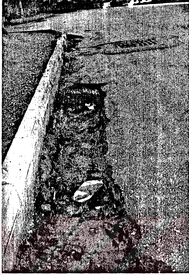
Resim 5.8. Yağış sularından oluşan bozulma
