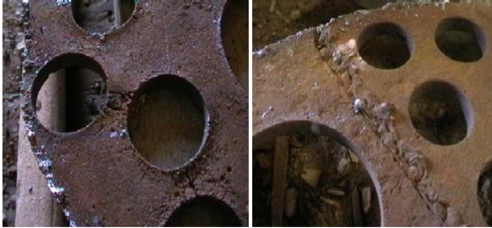
Şekil 2.6: Kazan borularının bitim noktasında oluşan korozyon ve çatlaklar
