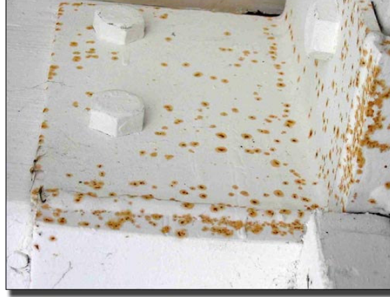
Şekil 4.7: Boyada "Rust (Korozyon, paslanma)" oluşumu.
