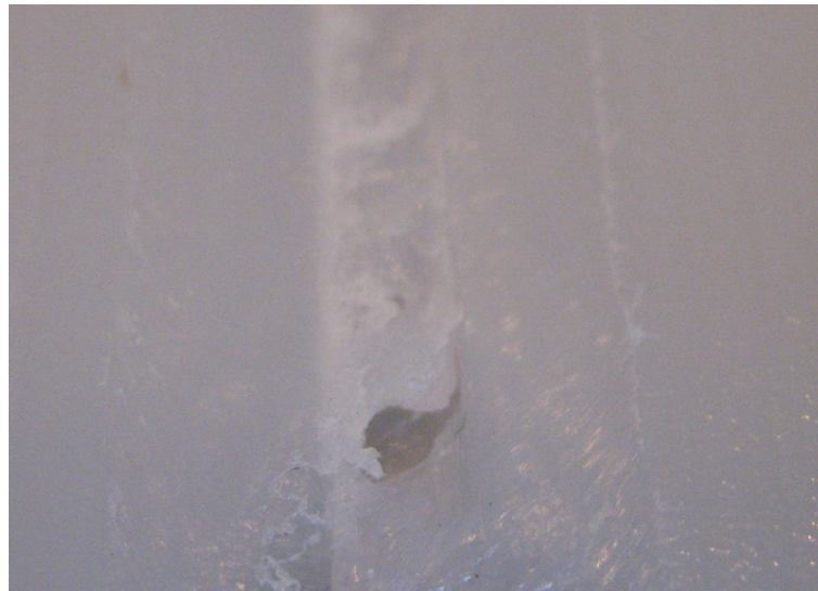
Şekil 4.16: Yine "5C" kodlu numune'de kaynak bölgesinde oluşan boşluk
