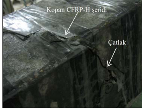
Şekil 6.7: Yüksek elastisite modüllü karbon elyafın çatlakla birlikte açılması durumu
