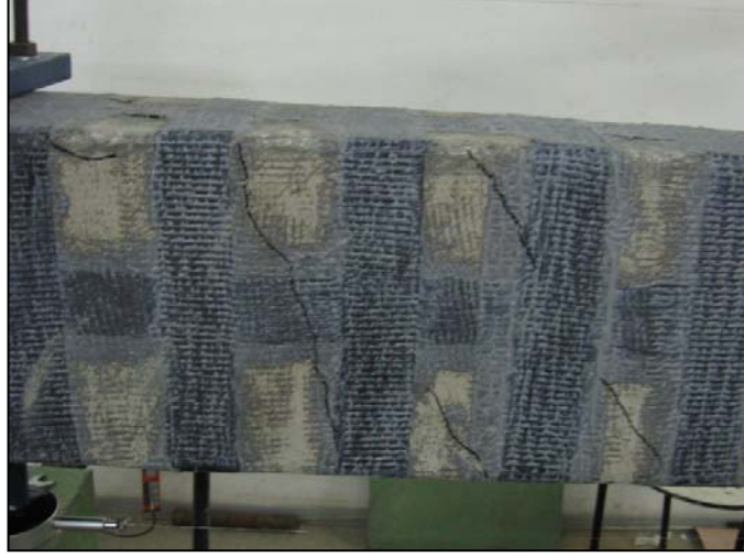
Şekil 6.4: A-N1CN-L1CN numunesinin \Theta=0.10 rad/m anındaki çatlak dağılımı
