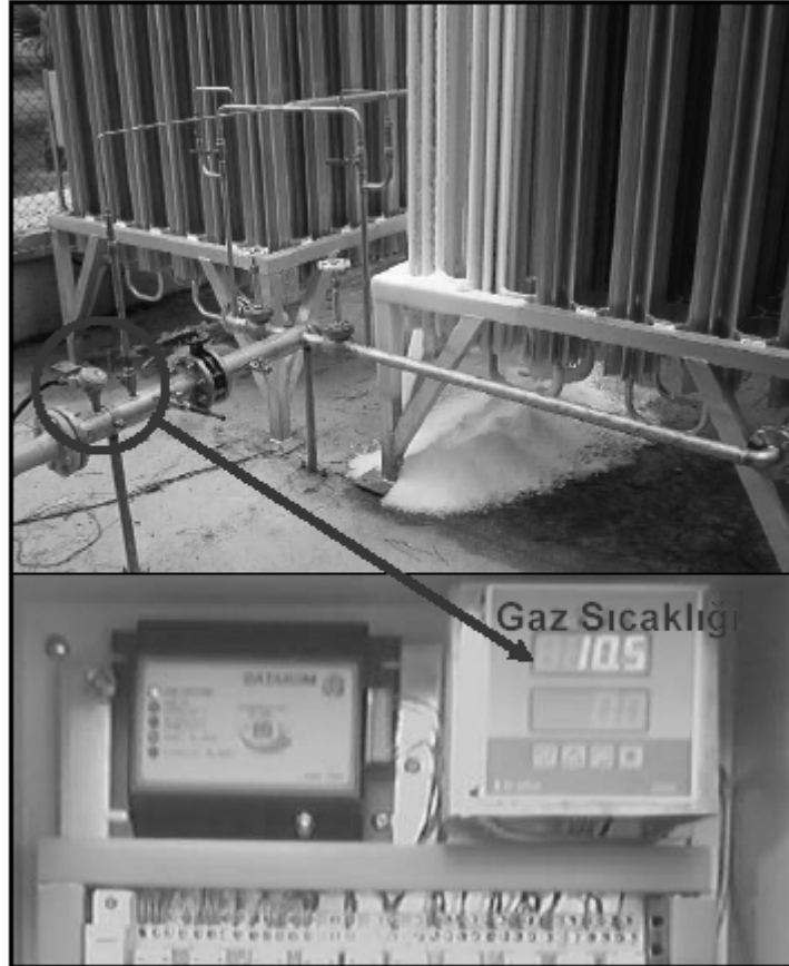
Şekil 5.5 Tank sahası sıcaklık transmitteri ve ana kumanda panosu içi termostatu (www.ipragaz.com.tr,2007)
