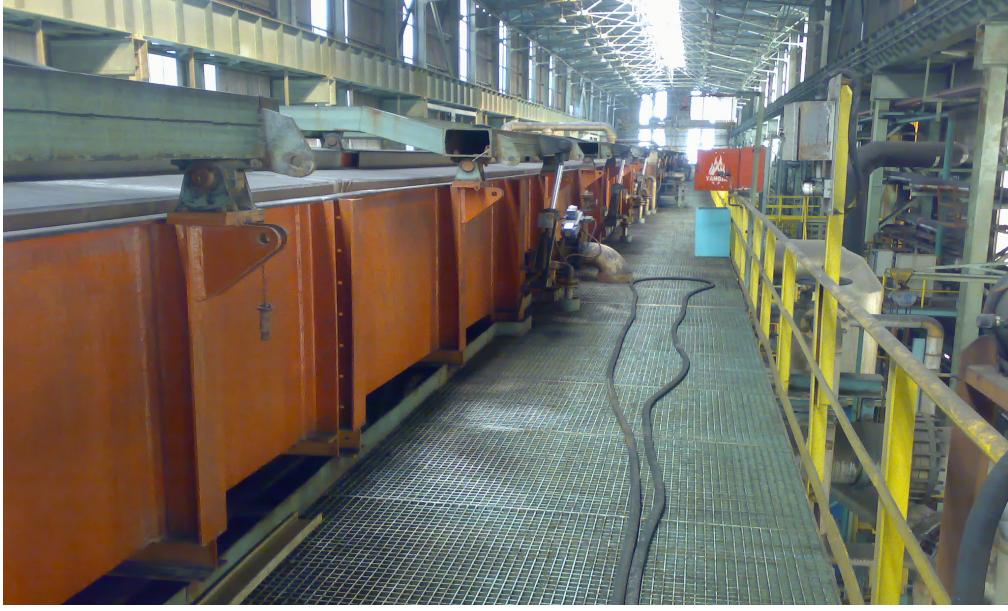
Şekil 6.5: Büyük tanklardan asit basılan, bobin asitlemesinin yapıldığı küçük tanklar ve hattın genel görünüşü
