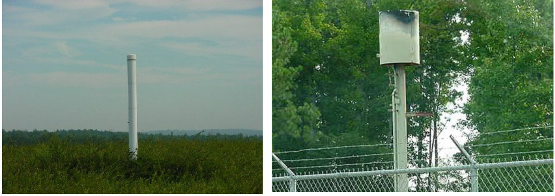
Şekil 2.9: Deponi gazı bacası (solda) ve yakıcı (flare) [1].
