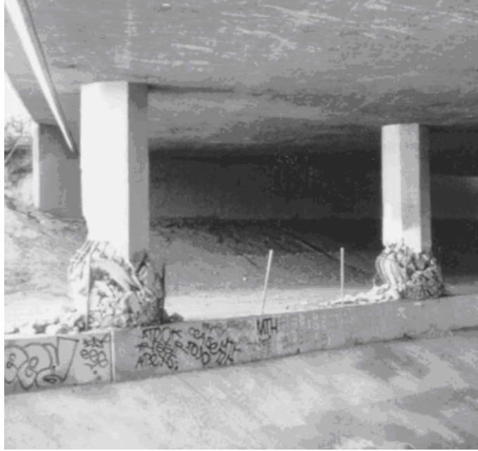
Şekil 1.12: Bull Creek Canyon Channel köprüsü hasarları [19]
