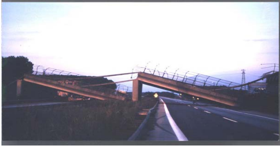
Şekil 2.13: Arifiye köprüsünde meydana gelen hasar [28]
