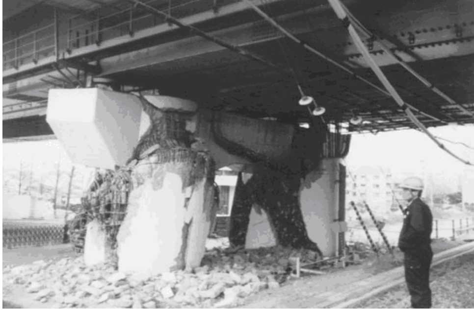
Şekil 1.10: 1995 Kobe depreminde iki viyadük ayağında meydana gelen hasarlar [19]
