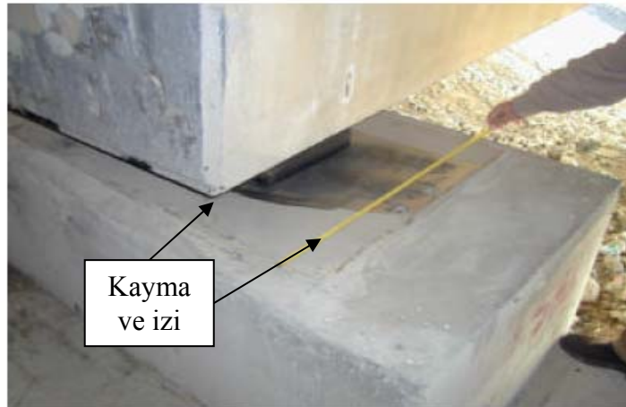
Şekil 1.20: Bolu viyadüğü elastomerik mesnetlerinde meydana gelen yerdeğiş-tirmelerin mesnet kayma izleri [11]
