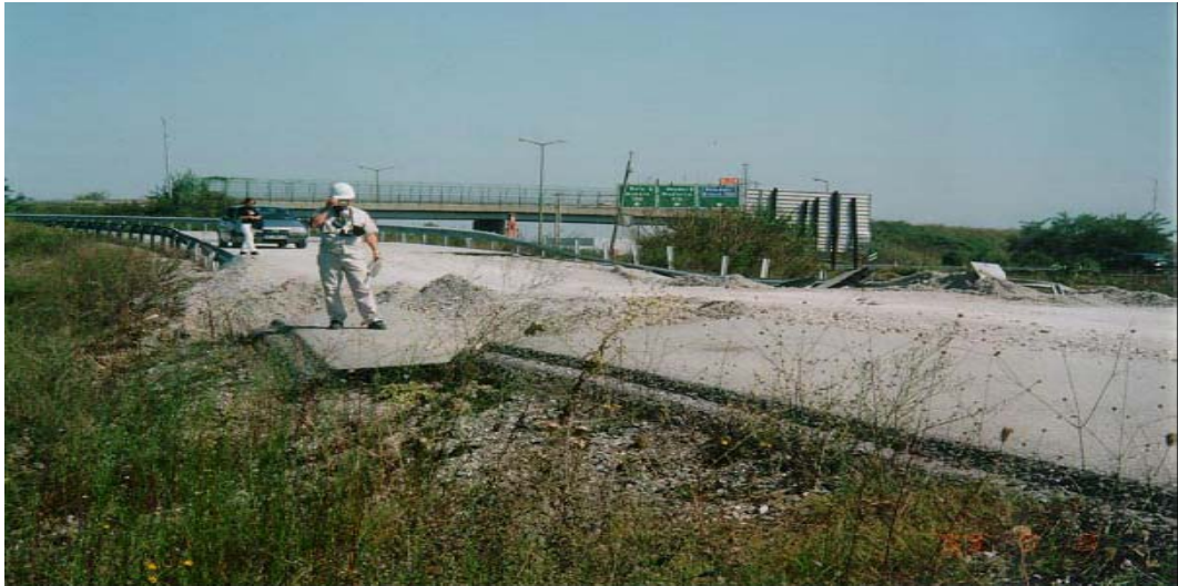
Şekil 2.14: Arifiye yakınlarında fayın geçtiği yolda meydana gelen hasar [28]
