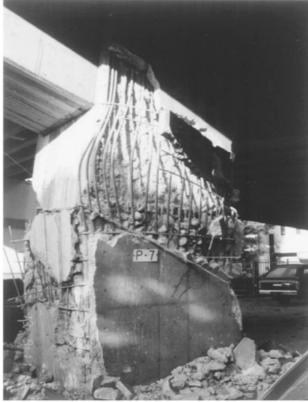
Şekil 1.9: 1995 Kobe depreminde viyadük kolonlarındaki yetersiz etriyenin neden olduğu hasar sonucu boyuna donatıların kesilmesi [19]
