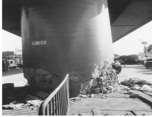
Şekil 1.6: 1995 Kobe depremi sonrası temel-viyadük ayağı birleşim noktasında meydana gelen plastik eğilme hasarı [19]
