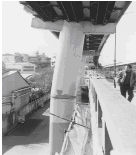
Şekil 1.13: 1995 Kobe depreminde köprü dairesel kolonlarında meydana gelen lokal burkulmalar [19]
