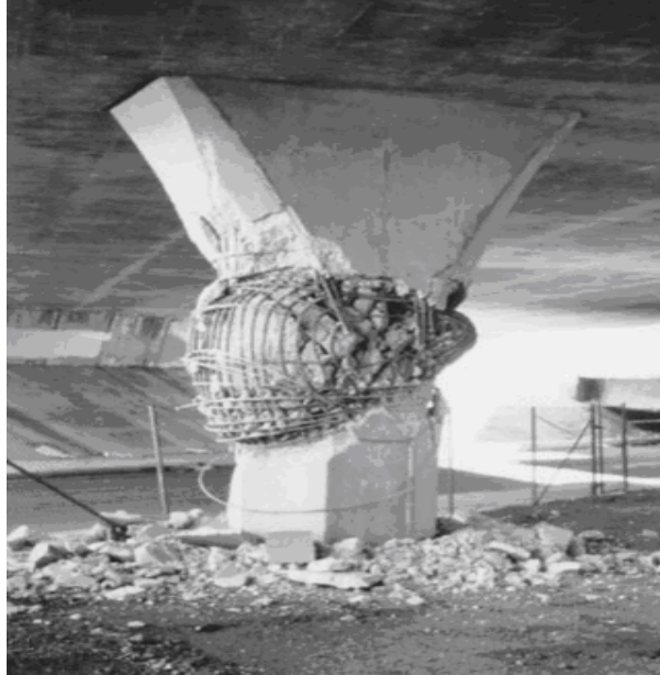
Şekil1.11: Mission Gothic köprüsü ayağı kesit küçülmesi sonucu gerilmelerin büyümesiyle oluşan eğilme hasarı [19]
