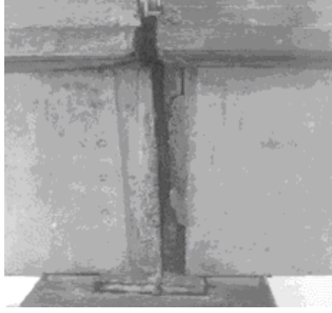
Şekil 1.21: 1989 Loma Prieta depreminde Napa river köprüsü prekast kiriş birleşim noktalarında meydana gelen çarpma hasarı [29]
