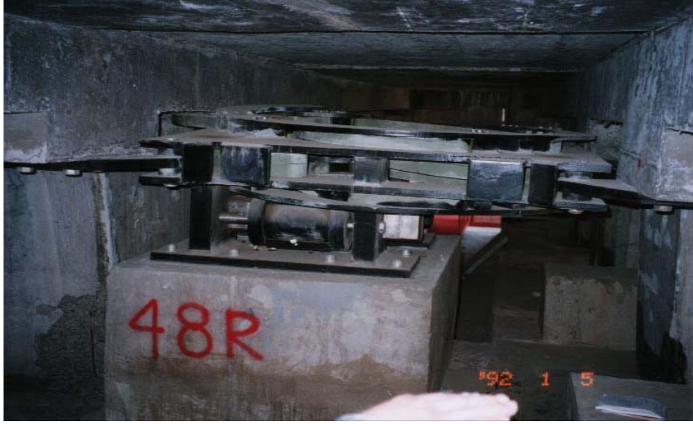
Şekil 1.22: Bolu viyadüğünde 1999 Düzce depreminde vizkoz sönümleyici mesnetlerde meydana gelen hasarlar [28]
