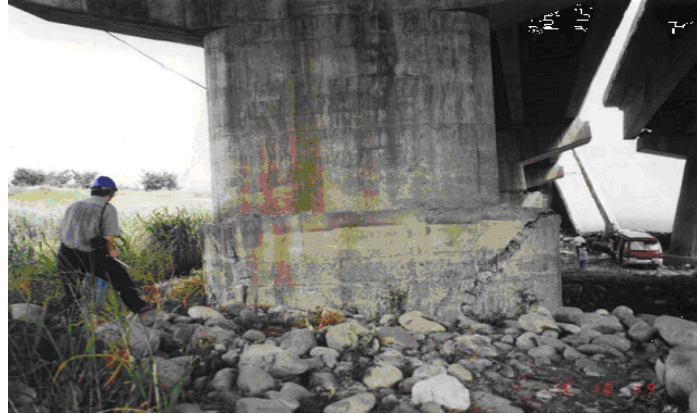
Şekil 1.5: Chi Chi depreminde Wu-Shi köprüsü temelinde fay hareketi sonucu meydana gelen kesme kırılmaları [28]
