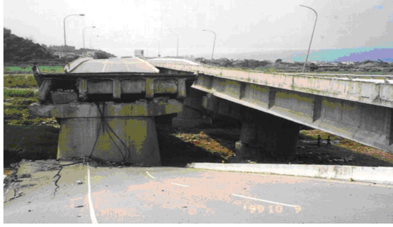
Şekil 1.15: Chi Chi depreminde Wu-Shi köprüsünde meydana gelen tabliye hasarı [28]
