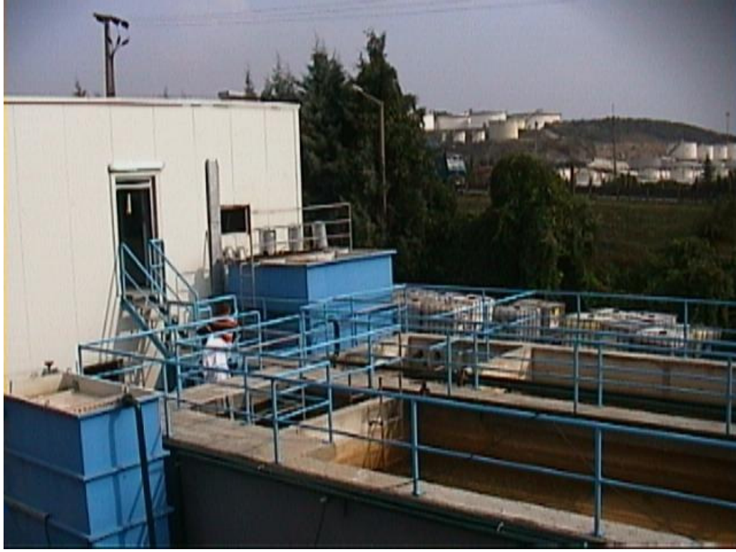
Şekil 2.6: Marshall endüstriyel atıksu arıtma tesisi görünümü
