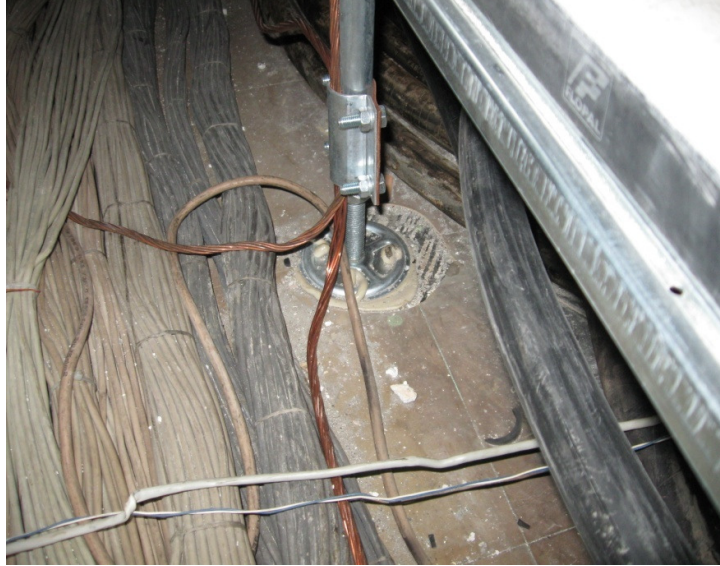
Şekil 3.8: Santral salonu yükseltilmiş taban bacalarının topraklanması
