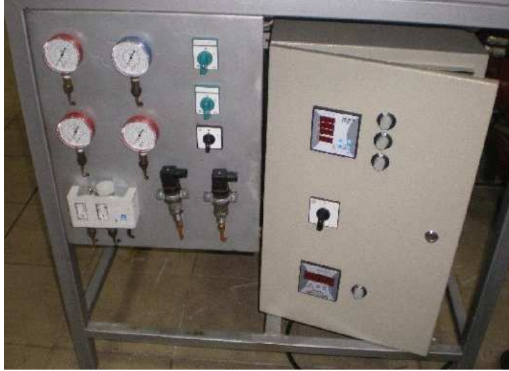
Şekil 3.3: Elektrikli cihazların kontrol panosu ve soğutucu akışkan basıncı ölçüm cihazları
