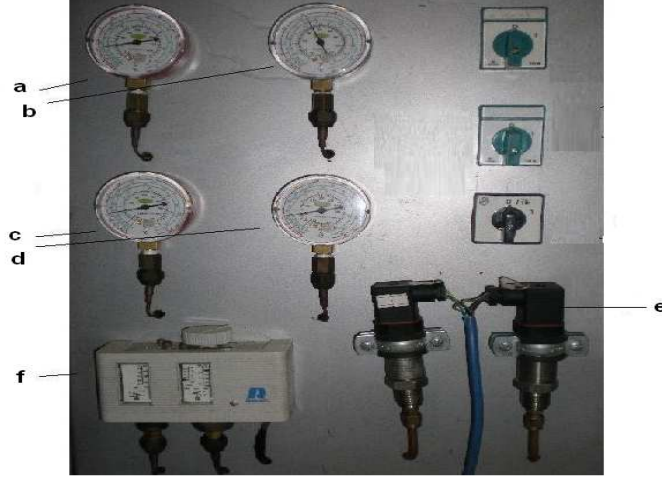
a-Buharlaştırıcı basıncı, b- Yoğuşturucu basıncı, c- Coriolis debimetre girişi, d- Coriolis debimetre çıkışı, e- Basınç transmitteri, f- Devre kesiciler
