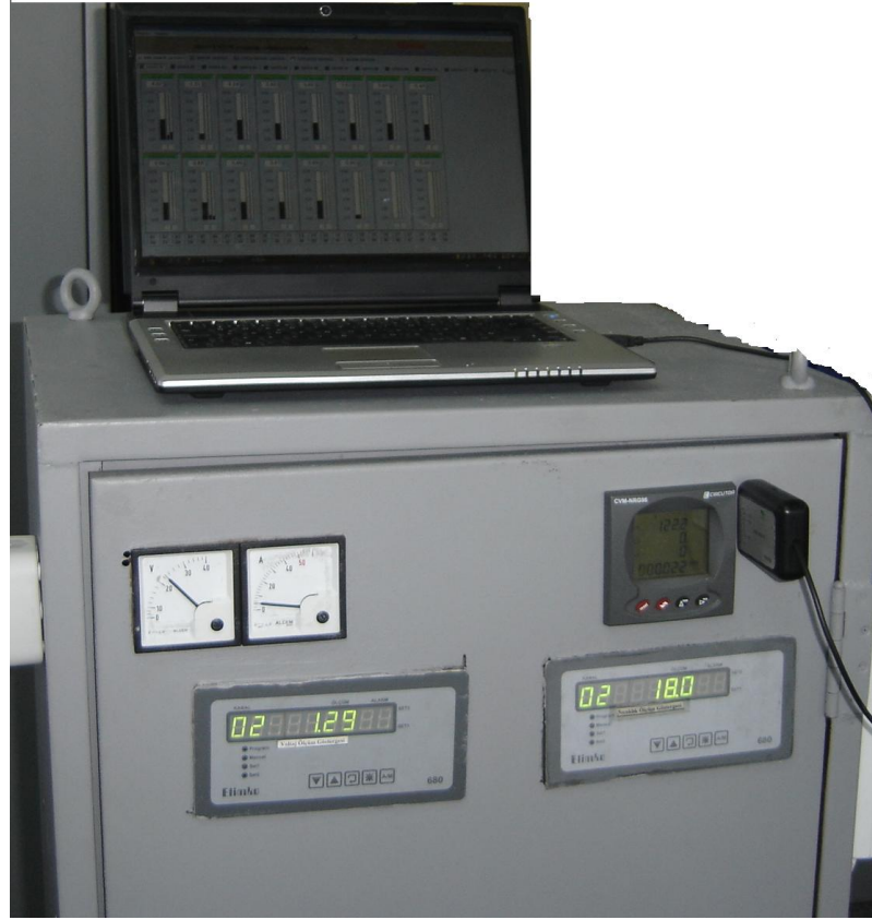
Şekil 4.72: Güç izleme sistemi görünümü
