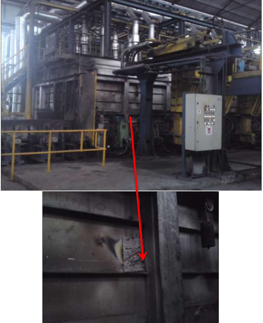
Şekil 5.11. Bir nolu kamera montaj bölgesi
