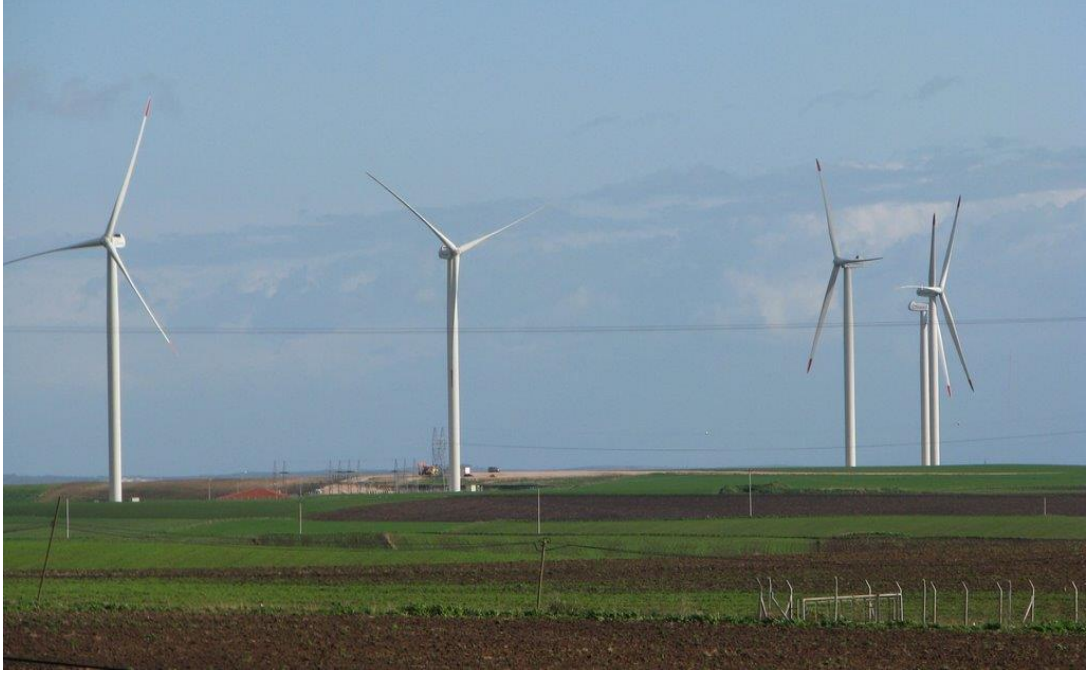
Şekil 1.5. Bandırma Bezirci Köyü 24 MW rüzgar enerji santrali
