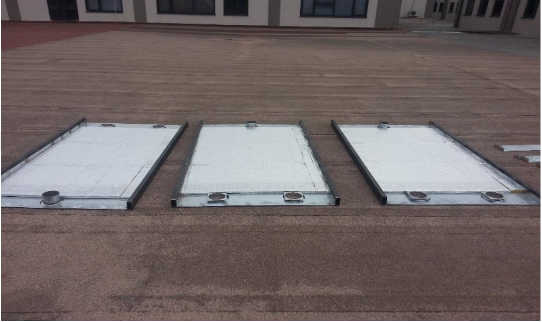
Şekil 4.1. Yalıtım malzemesi yerleştirilen kollektörler
