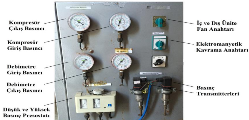
Şekil 2.5. Manometreleri, basınç transmitterlerini, presostatı ve anahtarları içeren kontrol panosu
