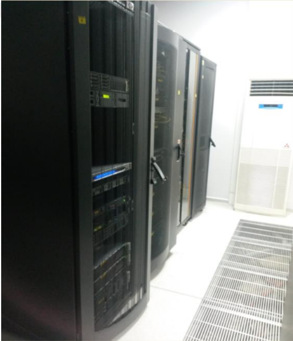
řekil 3.8. Özel řartlandırılmıř Bilgi İřlem odasında bulunan sunucular (server)
