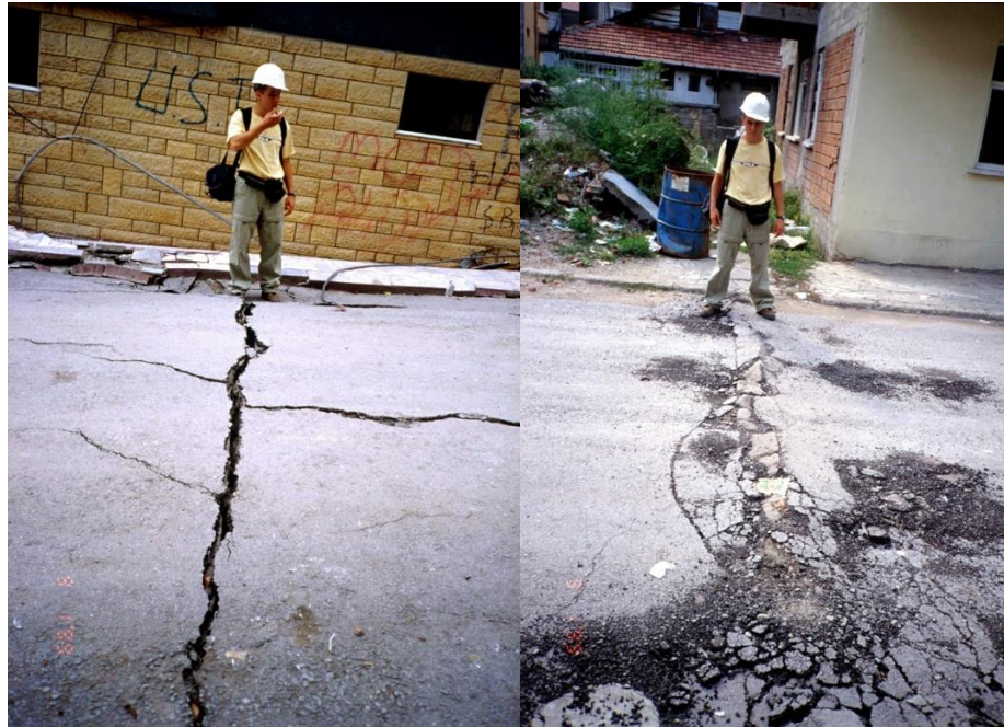
Şekil 3.9. Yakın Caddesinde yol üzerinde depremden sonra meydana gelen hasarlar (URL-4)
