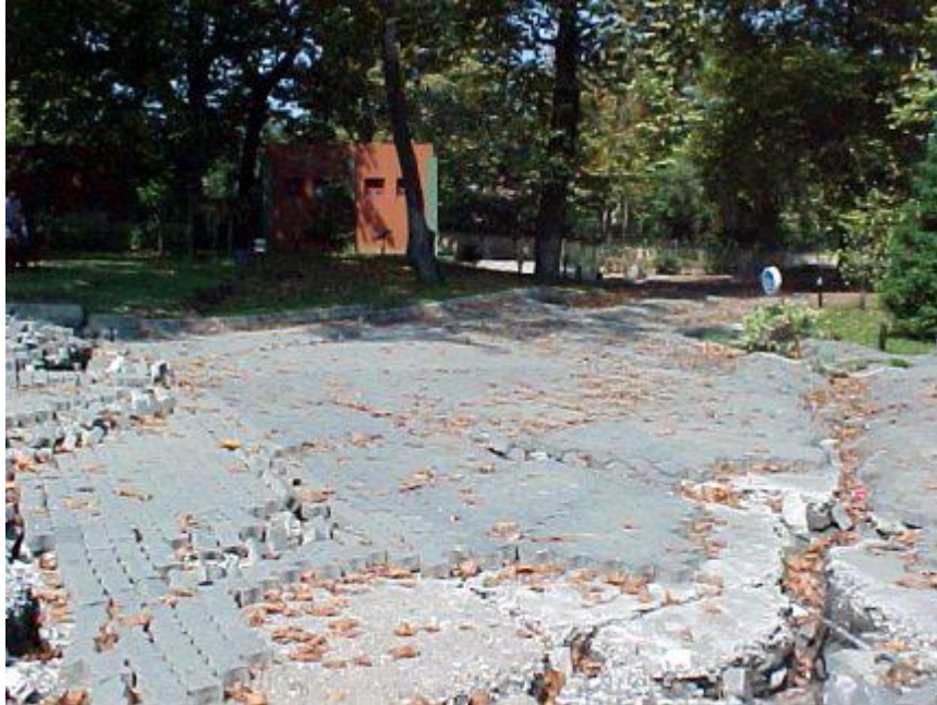
Şekil 3.7. Sapanca Vakıf Oteli çevresinde deprem sonrasında zeminde gözlenen deformasyonlar (URL-3)
