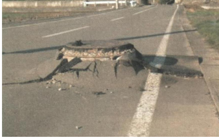
Şekil 1.8. 2000 Tottori depreminde gömülü yapı yükselmesi
