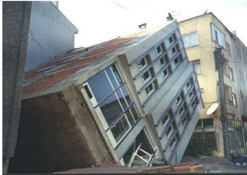
Şekil 1.5. 1999 Kocaeli depremi sonrasında zeminde taşıma gücü kaybı ile yenilen bir bina
